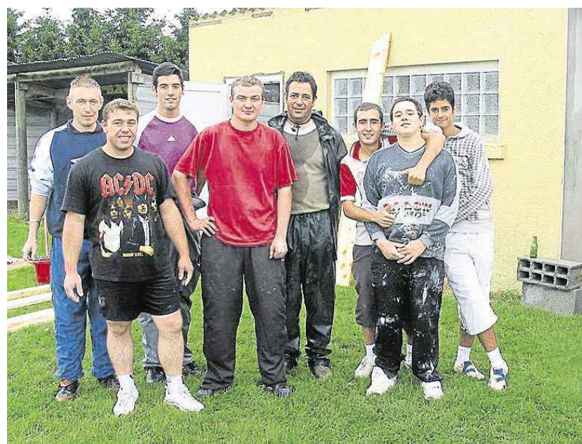
Autour du nouveau président Eddy Pauthonnier, une dizaine de bénévoles s'est relayée samedi pour effectuer des travaux aux vestiaires du stade.
